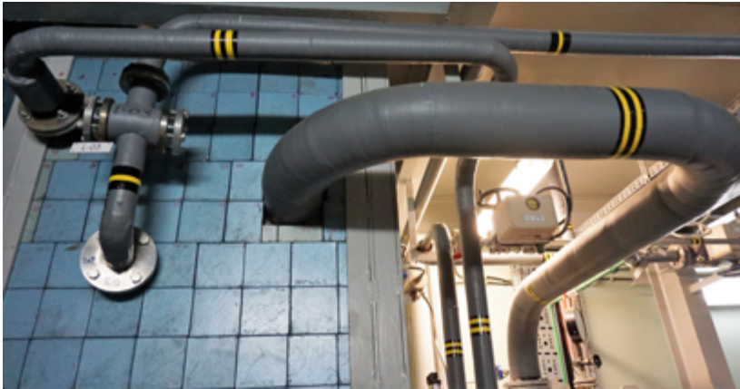
Fot. 6. Oznaczenia ścieków z zawartością substancji promieniotwórczych i stopnia ich skażenia w instalacji
